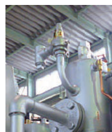
SD120のボイラー設置状況
