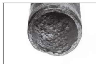
图CG-10. 系统中的氧气加速了管道的腐蚀（氧化），如图所示，管内表面坑凹不平。
